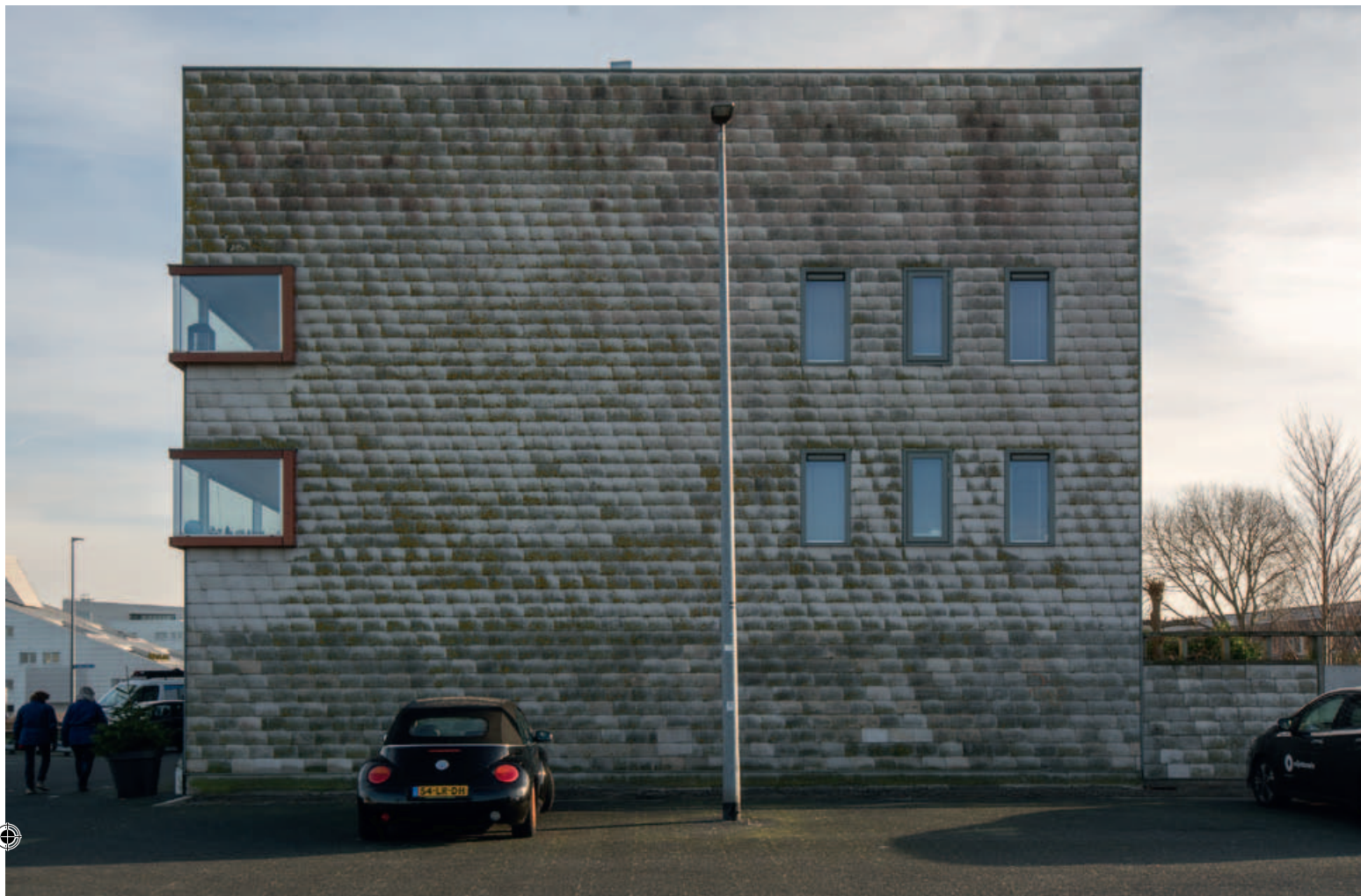
Een van de kopgevels. Onder de naar buiten stekende kozijnen van de hoekramen is de gevel niet vervuild door algvorming; daar is het niet zo vochtig.
